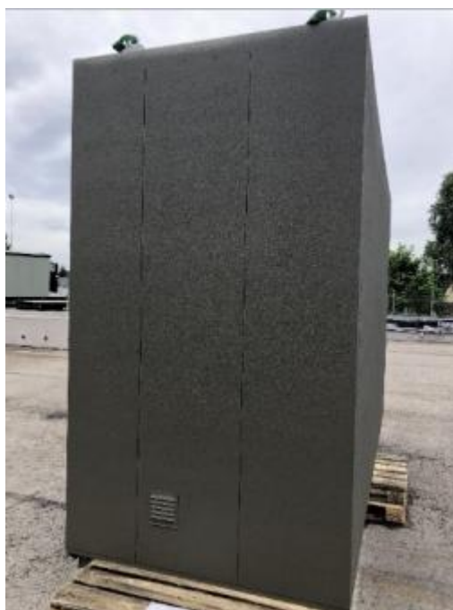
Figur 3-10. Eksempel på sekundær koblingsstation.
