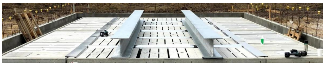
Figur 3-13. Dæk og jærdragere, som transformeren placeres på.
