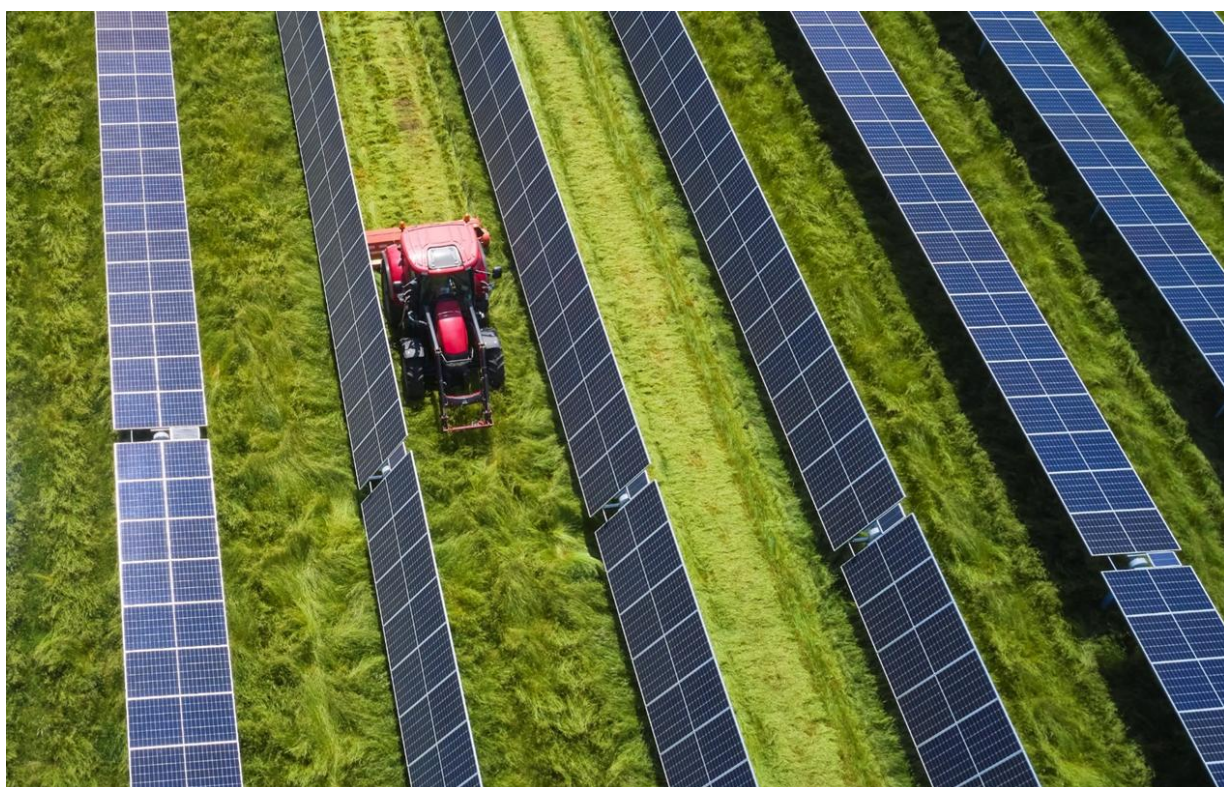
Figur 3-4 Eksempel på solcellepaneler på trackerstativer.
