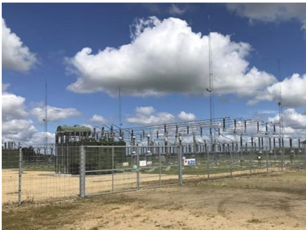
Figur 3-8. Eksempel på en transformerstation med effekttransformer tv. og tilhørende udendørs konstruktioner og lynafledere.
