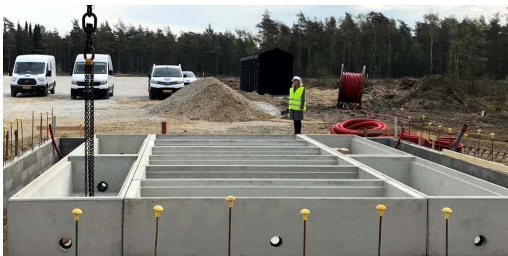
Figur 3-12. Betonkar under primær effektransformer.
