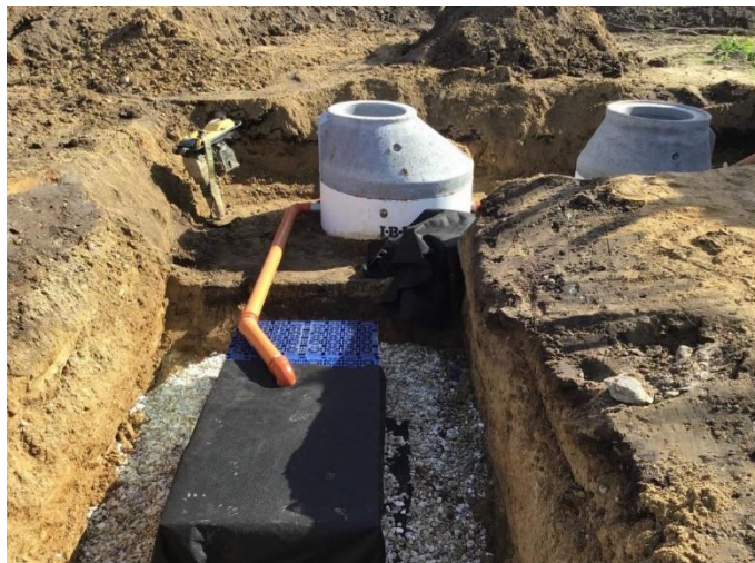
Figur 3-14. Olieudskiller og faskine. Nedsivning af overfladevand sker pba. en nedsivningstilladelse.
