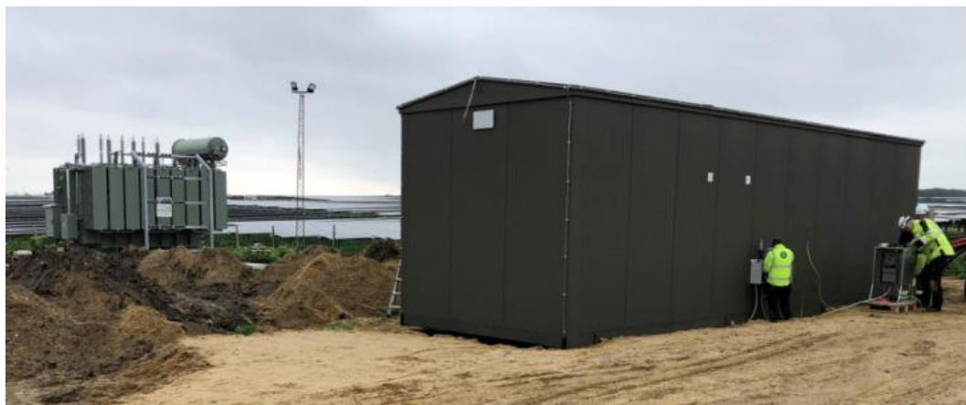
Figur 3-9. Eksempel på effektransformer tv. og primær koblingsstation th.
